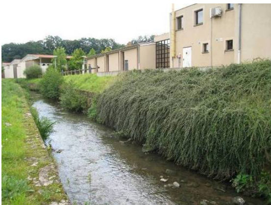
Dégradation physique des berges de la Rosselle dans la traversée de Hombourg (présence de résineux, de plantes ornementales, berges artificialisées...).
